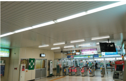
駅ホームのLED照明
