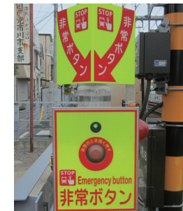
押ボタン式踏切支障報知装置
