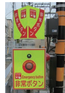
押ボタン式踏切支障報知装置
