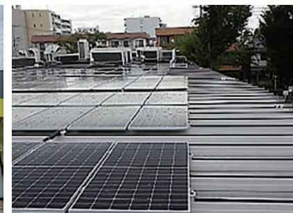
リブレ京成堀切店太陽光発電設備(京成ストア)
