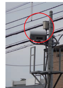
自動障害物検知装置
