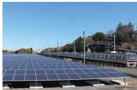
ちはら台太陽光発電所
