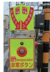
押ボタン式踏切支障報知装置
