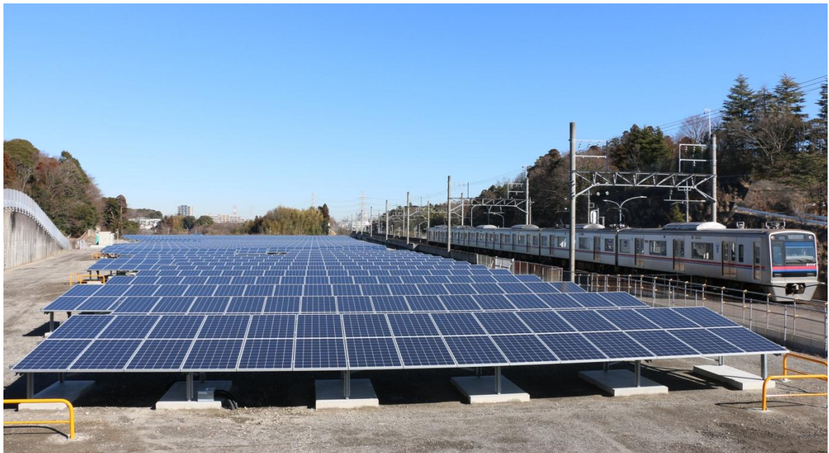
発電を開始した「ちはら台太陽光発電所」
