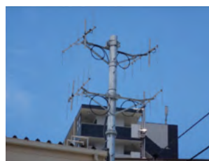
地上基地局 アンテナ
