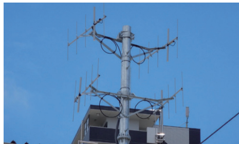
地上基地局 アンテナ
