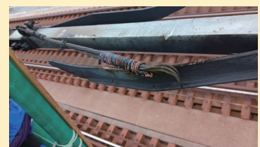
FRPセクション吊り線断線状況
