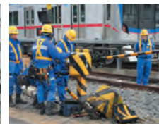
踏切遮断機倒壊復旧訓練
