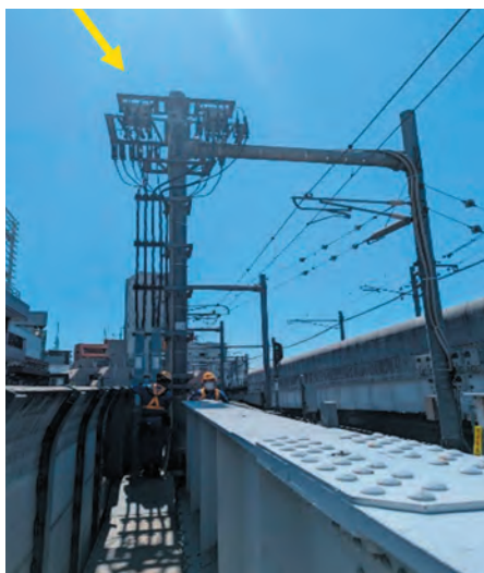
異常を発見した箇所
