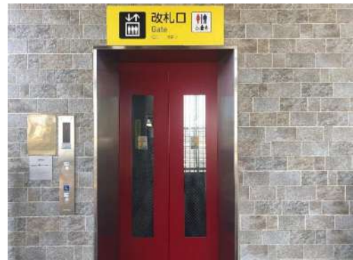
エレベーター
