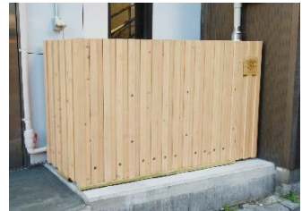
雨水利用タンク
