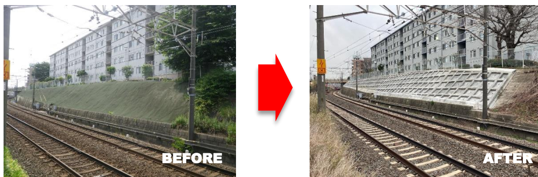
▲法面補強工事イメージ(谷津駅～京成津田沼駅間 2023年度実施)
