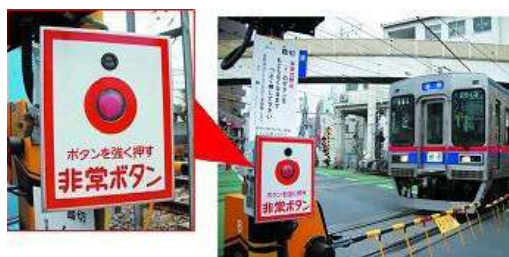
踏切支障報知装置
