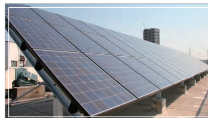
太陽光発電システム
