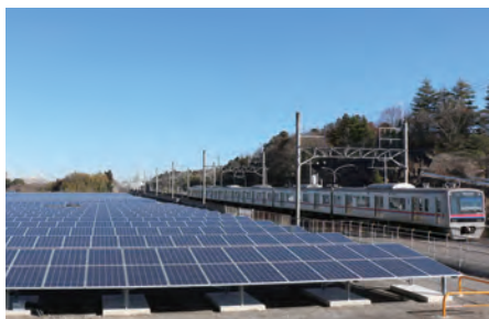
ちはら台太陽光発電所
