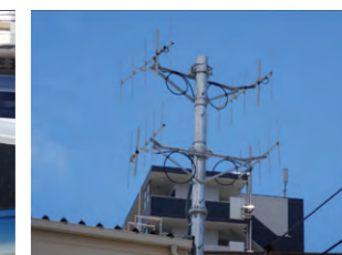
地上基地局 アンテナ
