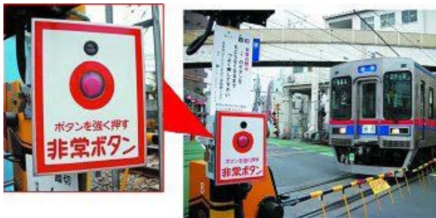
踏切支障報知装置（非常ボタン）
