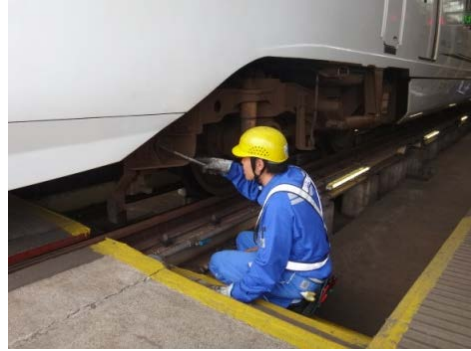
列車検査(床下機器点検)
