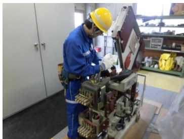
変電設備検査
