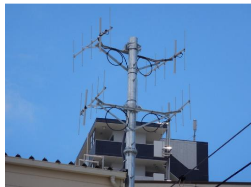
<地上基地局 アンテナ>
